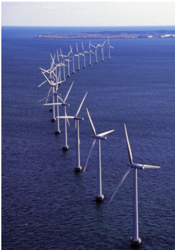
Tv: havsbaserad anläggning vid Horns rev på västra Jylland i Danmark där flera bågformade rader finns uppförda.
